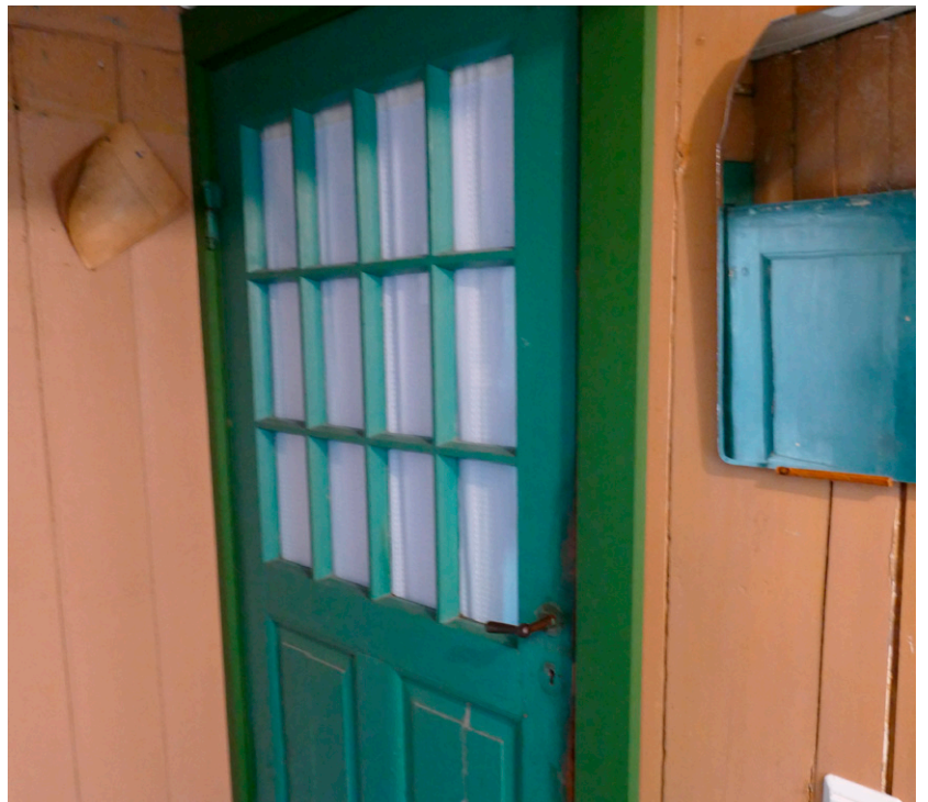
Hon återanvänder dörrar. Den här leder till duschen.
